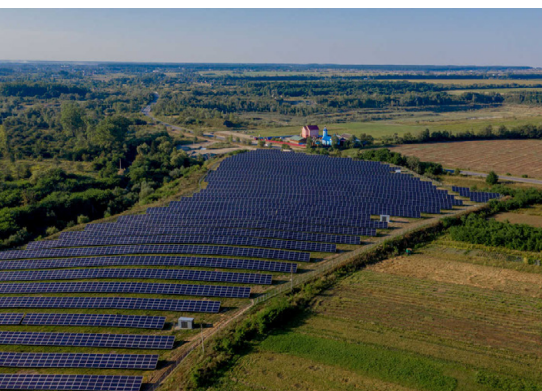
Impianto Fotovoltaico per uso Agricolo
